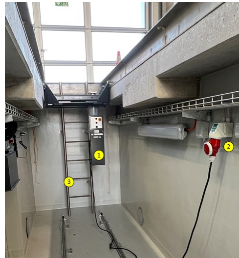
Abb. 6.4 Prüfgrube CCVP Giornico
