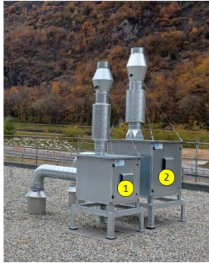
Abb. 6.18 Dach-Ventilatoren CCVP Giornico
