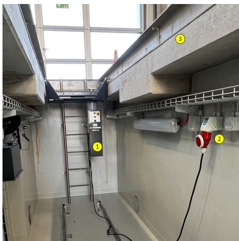
Abb. 6.11 Prüfgrube CCVP Giornico
